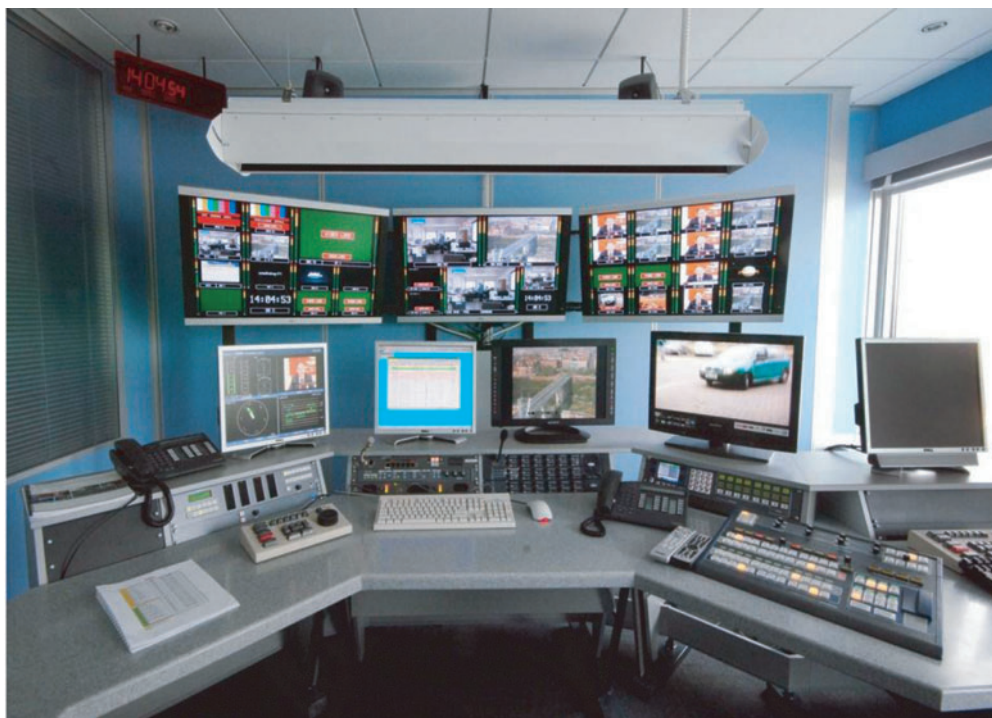
Soudobé digitální odbavovací pracoviště ve výškové budově na Kavčích horách. Archiv Čt. [3]
